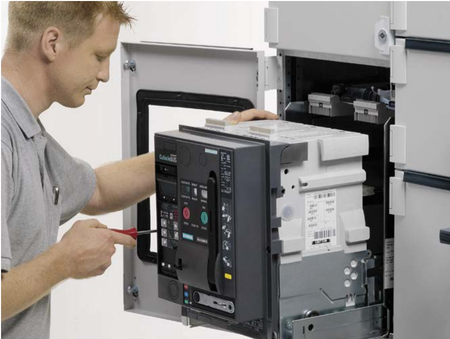
Inspektion des offenen Leistungsschalters 3WL ohne Entnahme möglich
