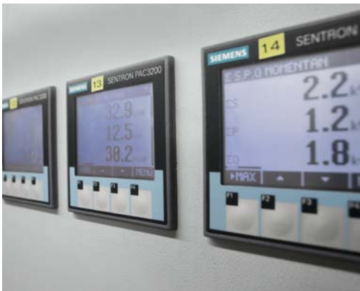
Innovative Geräte der SENTRON-Familie für das Erfassen und Bereitstellen der Verbrauchsdaten und elektrischen Kennwerte
